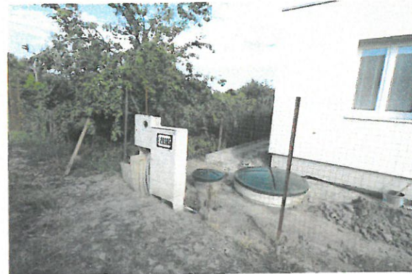
Rozvodná skriňa elektroinštalácie na pozemku p.č.3004
