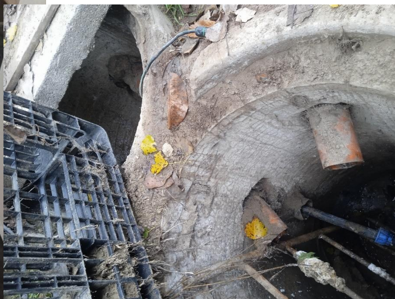
Nezakryté kanalizačné šachty
